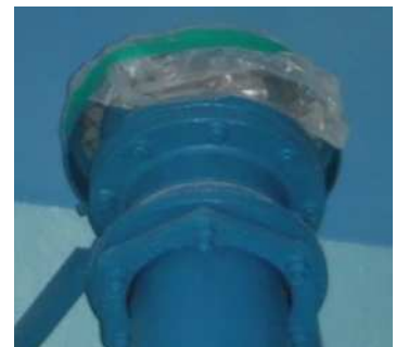
図1. 事故発生時のオーバーフロー管の密閉状況（隙間が見られる）
