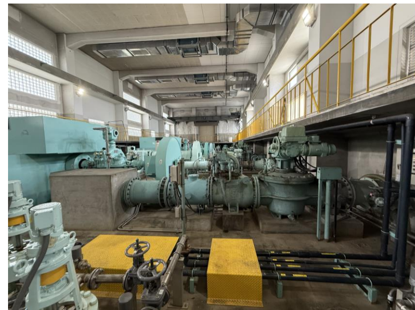
神崎川ポンプ場のポンプ
