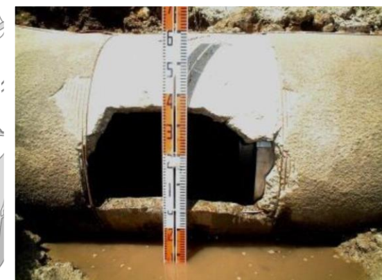
コンクリート管の破裂事例
