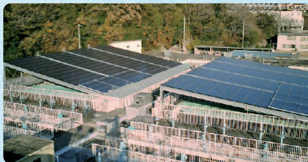
奥平野浄水場太陽電池パネル
