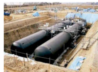
大容量貯水槽の整備
