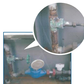
老朽化した給水管
