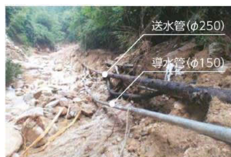
土砂崩れによる管路の露出（平成 26 年 8 月）
