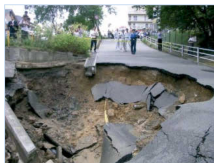
水道管の漏水による道路陥没
